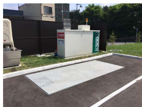
大量の雪を処理できる融雪槽
