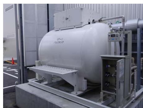
LP ガスバルク貯槽ユニット
