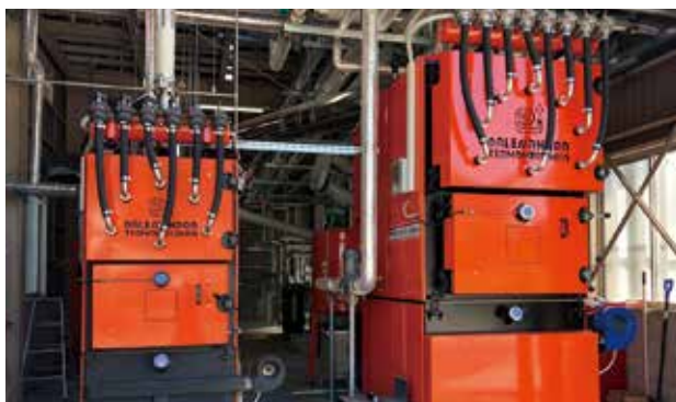
地域熱供給用バイオマスボイラー
