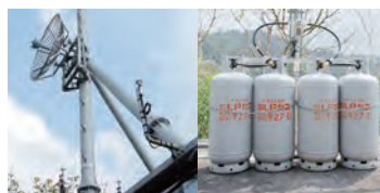
3つの基地局に設置されています
