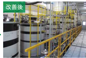
改善後 地上に設置した廃液貯槽 (漏えいの目視確認が可能)
