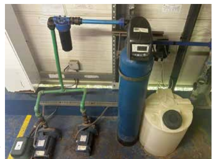
処理槽・ろ過フィルター
