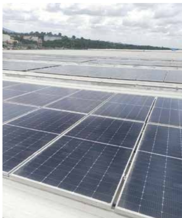
工場に導入した太陽光発電設備
