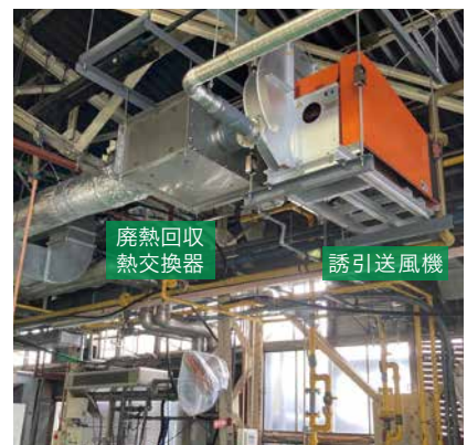
廢熱を回収する熱交換器
