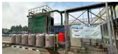
クーリングタワーと貯水タンク
