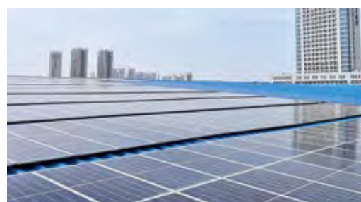
工場に設置した太陽光発電設備
