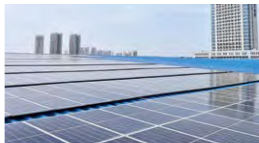
工場に設置した太陽光発電設備
