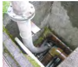
(改善前) 配管内に材料が接触することで騒音が発生
