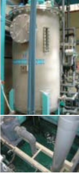
生活排水処理場の砂濾過設備
