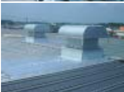
屋上に設置したルーフファン
