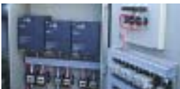
インバータ制御盤
