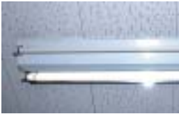
ダミー管と反射板を併用した照明
