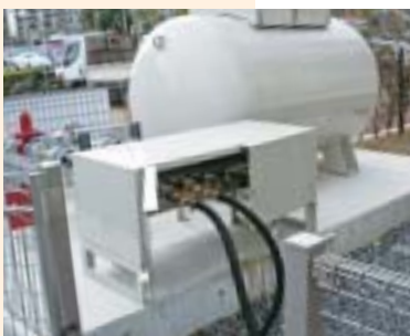
災害時には地元住民に開放されるガスバルク
