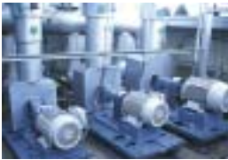
二次冷温水ポンプ
