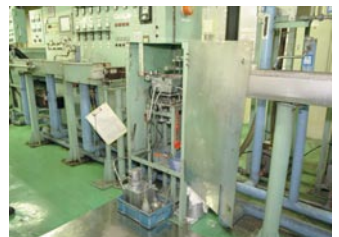
【沼津製作所】トランスのタップの切り替えにより配電電圧を適正化
