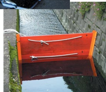
【富士工場】 水質汚濁・火災防止用の脱着式排水せき
