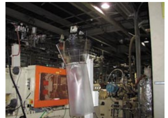
【榛原工場】モーター駆動方式から変更したエアカッター方式
