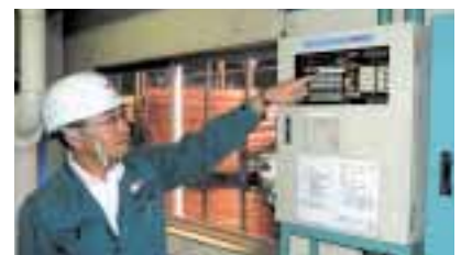
コンプレッサーの圧力制御表示盤
