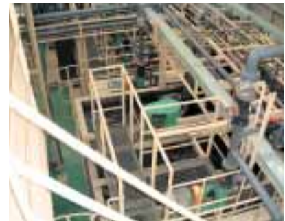
めっき排水処理場
