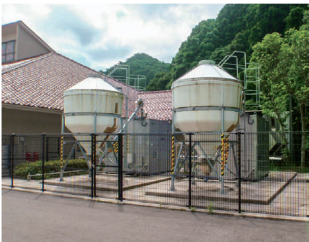
隠岐の島町図書館に設置された、木質ペレット焚吸収冷温水器『バイオアロエース』
