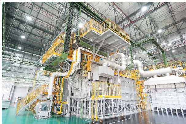
(新工場の溶解設備)
